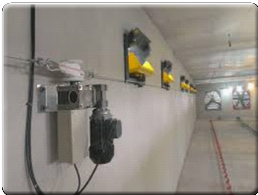
نصب اینلت و سیستم تهویه در سالم مرغداری
