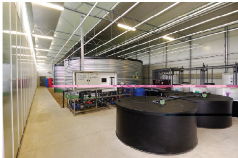
شکل 2-3- مخازن سیستم کودآبیاری در گلخانه
