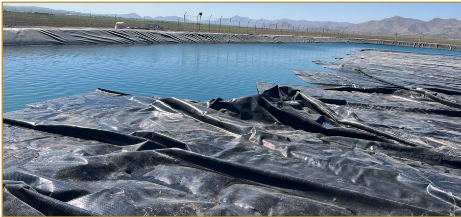
شکل ۵- نمونه‌ای از کاربرد پوشش شناور در استخر ذخیره آب کشاورزی
