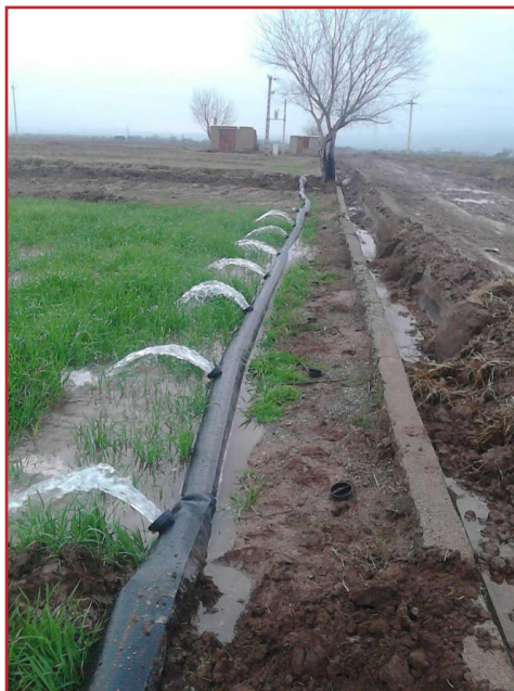
شکل ۲- نمایی از سامانه آبیاری کم فشار در حال آبیاری
