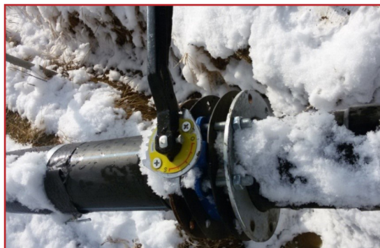
شکل ۱۰- اتصال شیر پروانه‌ای ویفری به آبریز (مزرعه عابدی، شهرستان سلماس؛ روستای صدیقیان)
