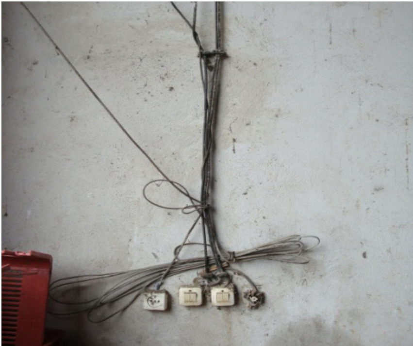
شکل ۳۰- استاندارد نبودن سیستم برق انبار و احتمال خطر حریق
