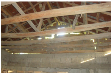
شکل ۱۱- سقف نامناسب و بدون عایق‌بندی
