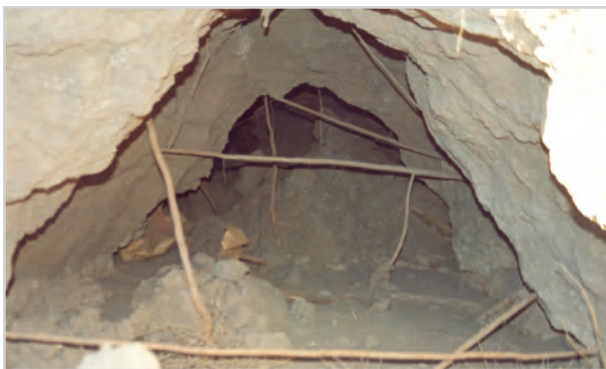
شکل ۲۷- ایجاد شکاف و آبشستگی در دیواره بندسار
