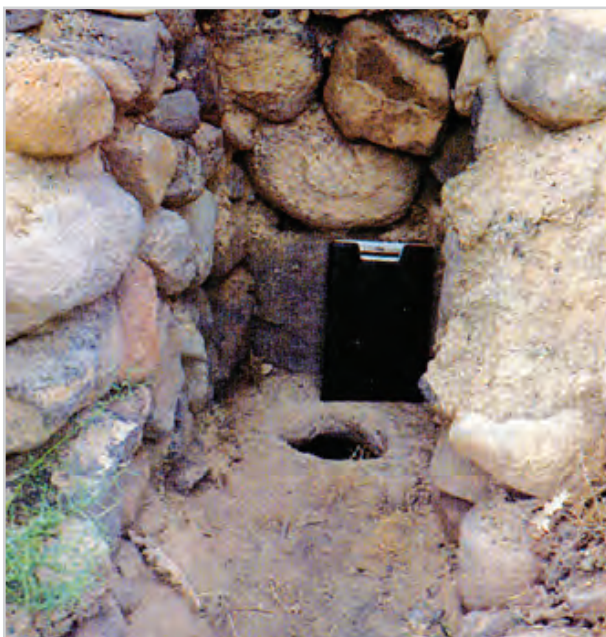
شکل ۱۷- سازه ای بنام قعر که برای تخلیه سیلاب و یا انتقال آب آبیاری از بدنه بند استفاده می شود.
