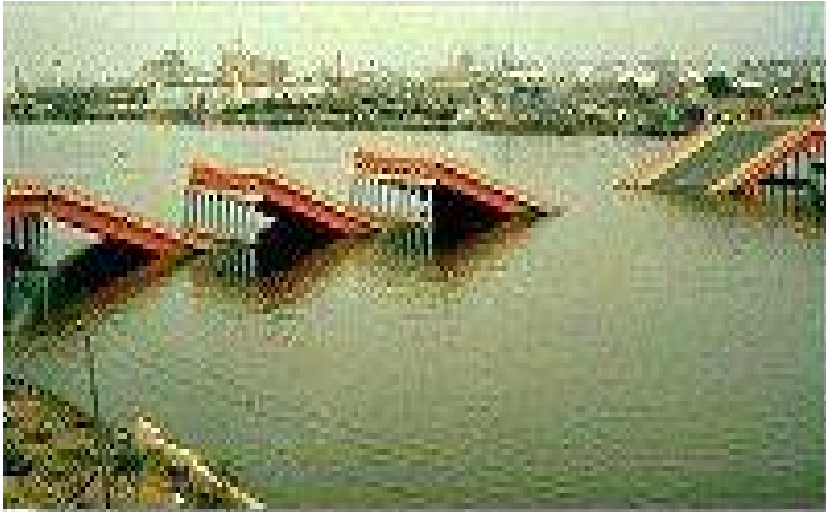
شکل 2- پی پل که در اثر حرکت‌های جانبی ناشی از پدیده روان‌گرایی آسیب دیده است (زلزله نیگتا، ژاپن 1964)
