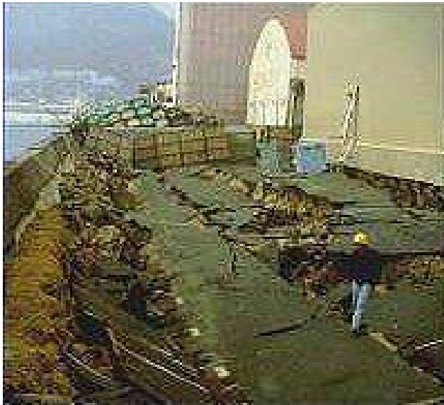
شکل 3- نشست خاک روان‌گرا در پشت دیوار حائل
