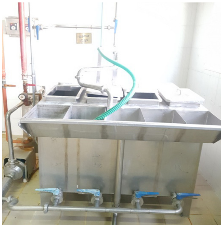
شکل ۱۷- مخزن شستشوی درجا برای شستشوی خطوط و تجهیزات
