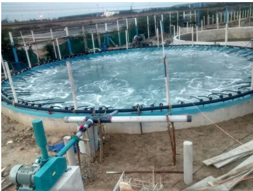
شکل ۲۸- دستگاه هواده مرکزی (بلوئر) در یک حوضچه گرد
