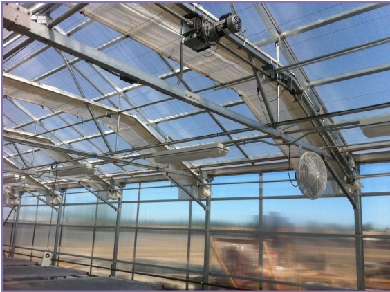
شکل ۵- سیستم برقی جمع‌کن و بازکن سایه‌انداز داخل گلخانه
