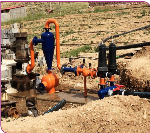
شکل ۲- سیستم فیلتراسیون در ایستگاه کنترل مرکزی
