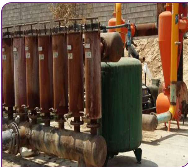
شکل ۲۵- ایستگاه پمپاژ و فیلتراسیون آبیاری سیستم قطره‌ای
