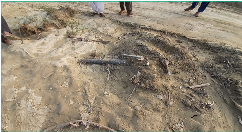
شکل ۹. نمایی از خسارات سیل به شیرفلکه‌ها و لوله‌های انتقال و توزیع آب
