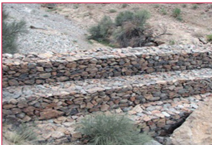
شکل ۱-۱۰- تصویر یک سد گابیونی در کف رودخانه درجه ۴
