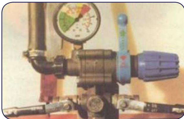
شکل ۴۲. مجموعه شیر فشارشکن
